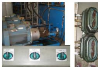
Avstängning av hydraulik och belysning vid driftstopp
