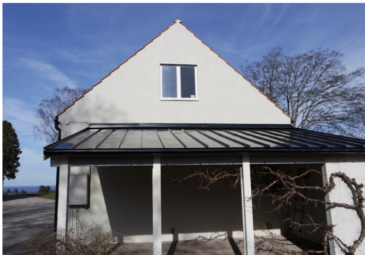
Figur 7 Plåttak med integrerade tunnfilmsmoduler 15
