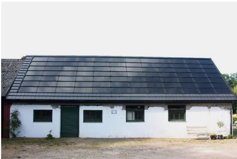
Figur 4 Solcellstak med integrerade reguljära moduler 12
