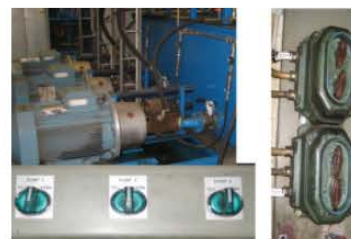
Avstängning av hydraulik och belysning vid driftstopp
