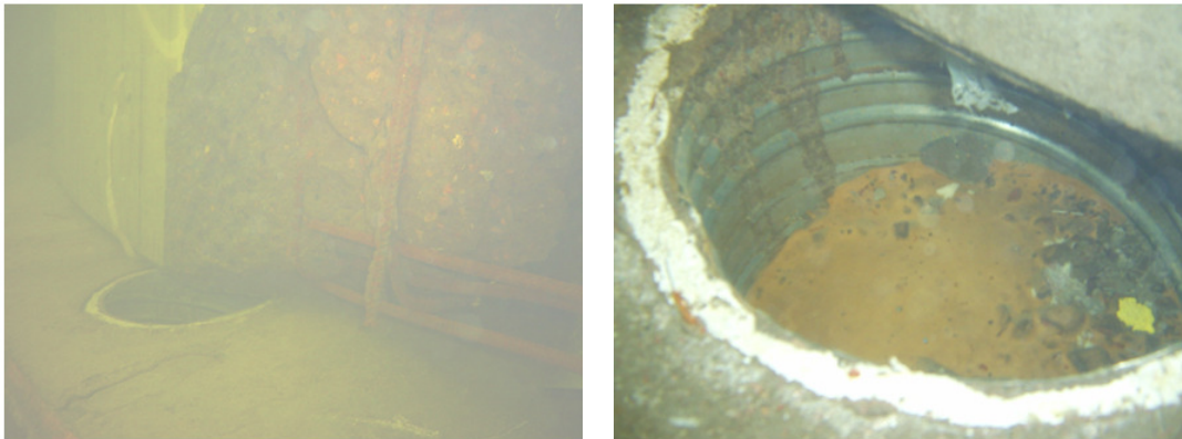
Figur 7.4 Förskjutning av fundamentringar efter storm oktober 2008.
