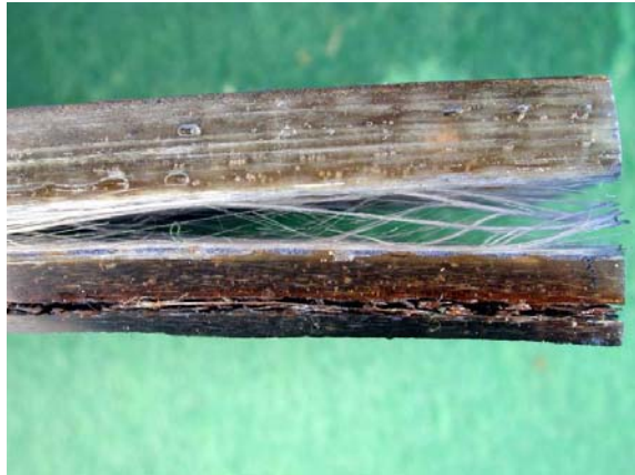
Figur 42. Omfattande delamineringsskador i GAP laminat där delaminering har skett både i spärretsiktet (nederst) och i styrkelaminatet nära spärretsiktet (mitten).
