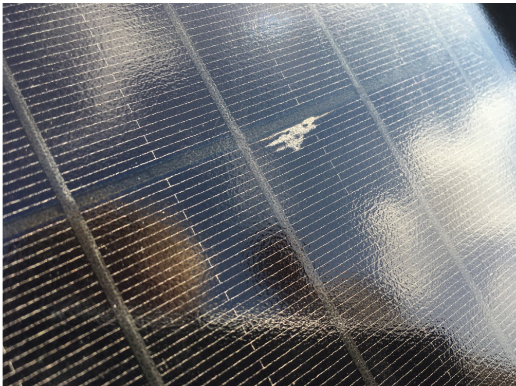
Defekt på ledare i en cell
