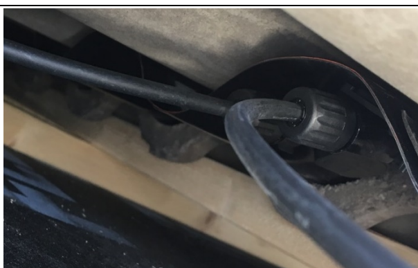
Figur 20. För Benders SunWave har modulerna inga fasta kablar, utan kontakterna sitter direkt i modulerna.
