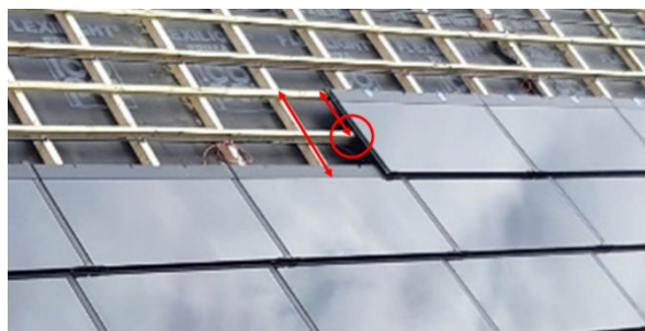
Figur 12. Läktning för Soltech Roof. Måtten fick anpassas på plats för att ge bra stöd åt modulerna.
