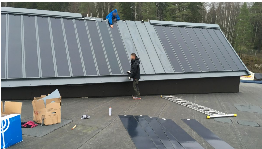
Figur 38. Byte av de 8 av 25 solcellsmoduler från Lindab som var skadade och vars energiproduktion var avsevärt lägre än specificerat i datablad. Modulerna drogs bort från plåten och nya moduler limmades tillbaka.
