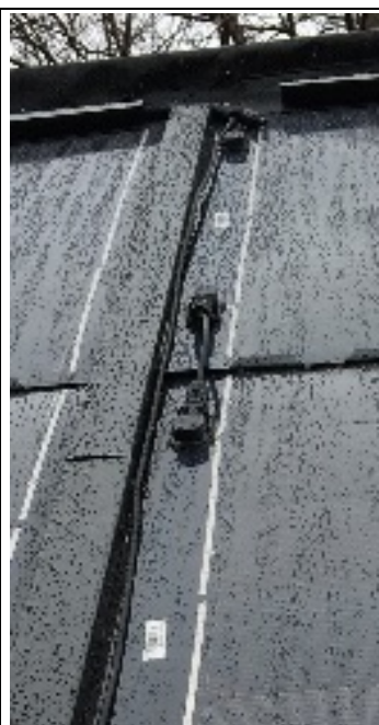
Figur 25. Återföringskabeln ligger här helt parallellt med modulsammankopplingen, och täcks sedan med en täckplåt (ej monterad).
