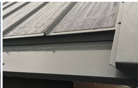
Figur 33. Lindabs bandplåt vilar på läkt, men det saknas öppningar som tillåter cirkulation i luftspalten.
