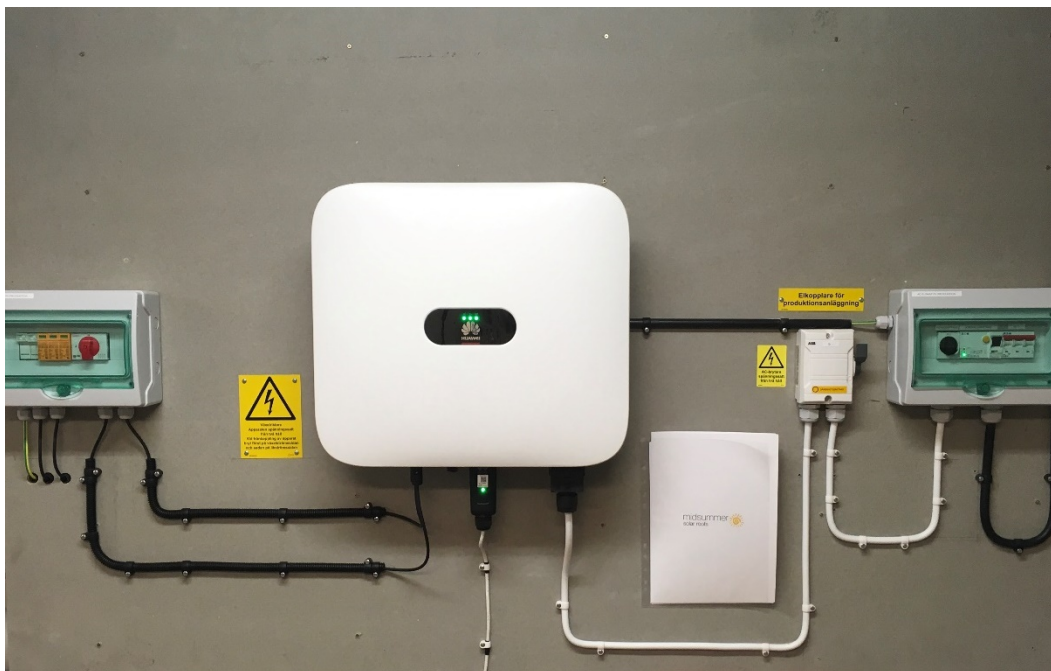
Figur 35. Midsummers installation av växelriktare och kopplingsutrustning. Ingen utrustning har placerats inom det fria avstånd som installationsanvisningarna anger.
