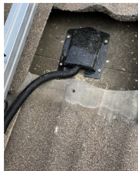
Figur 28. Ej polseparerad genomföring, skyddad med takavluftningsdon. Slangen med kablarna kläms mellan tegelpannorna.
