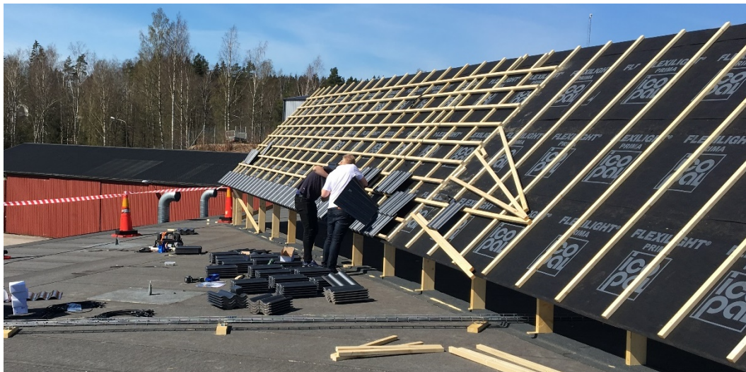
Figur 13. 6 av 9 solesystem installerades på takkonstruktioner som byggts specifikt för genomförandet av projektet. Två system samsas om utrymmet på ett tak som mäter 3,55 m x 20 m.
