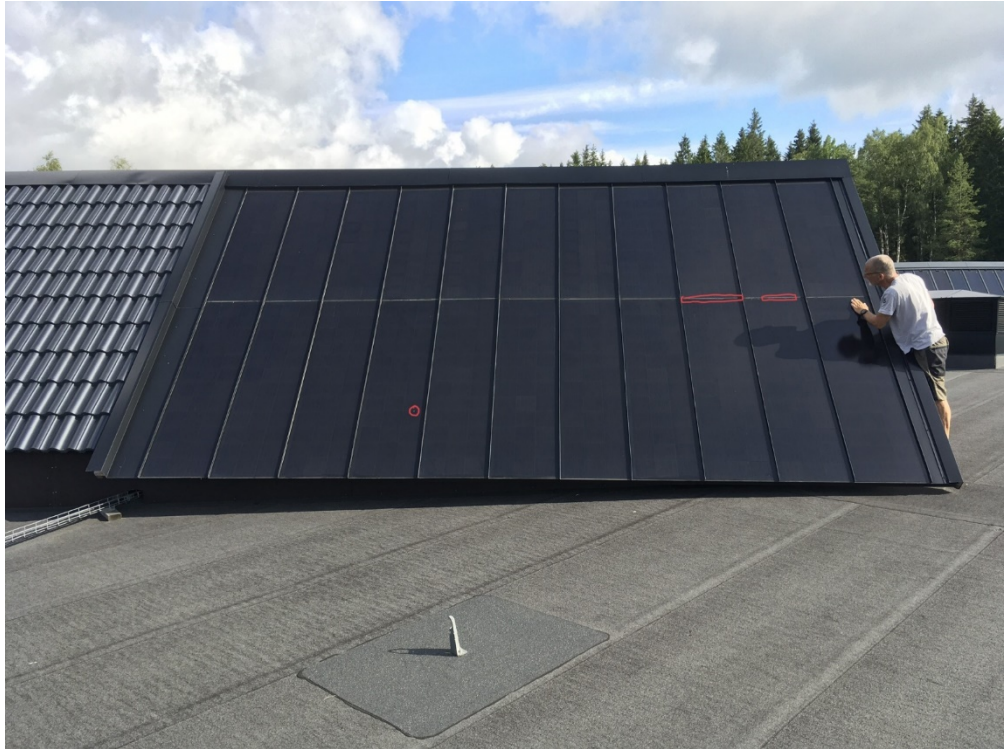
Markering av defekter
