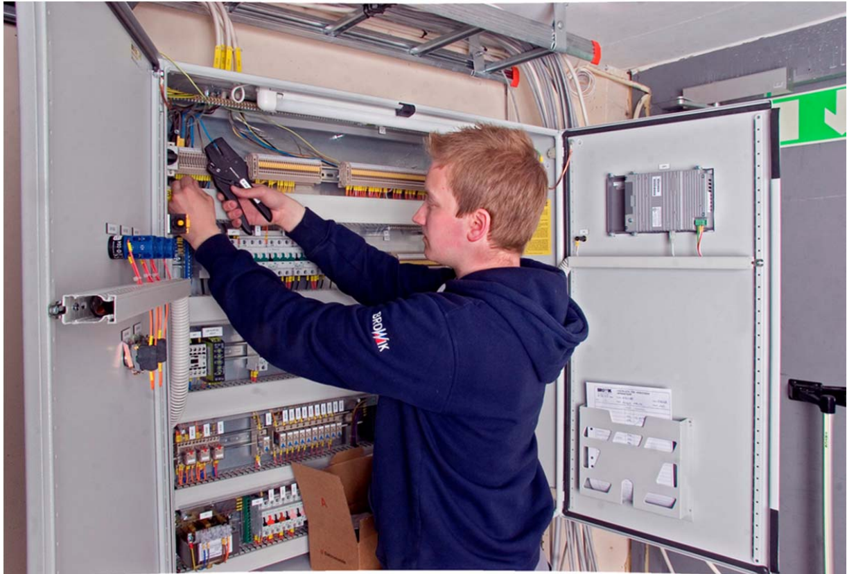
Foto: Elektriska installatörsorganisationen, EIO
