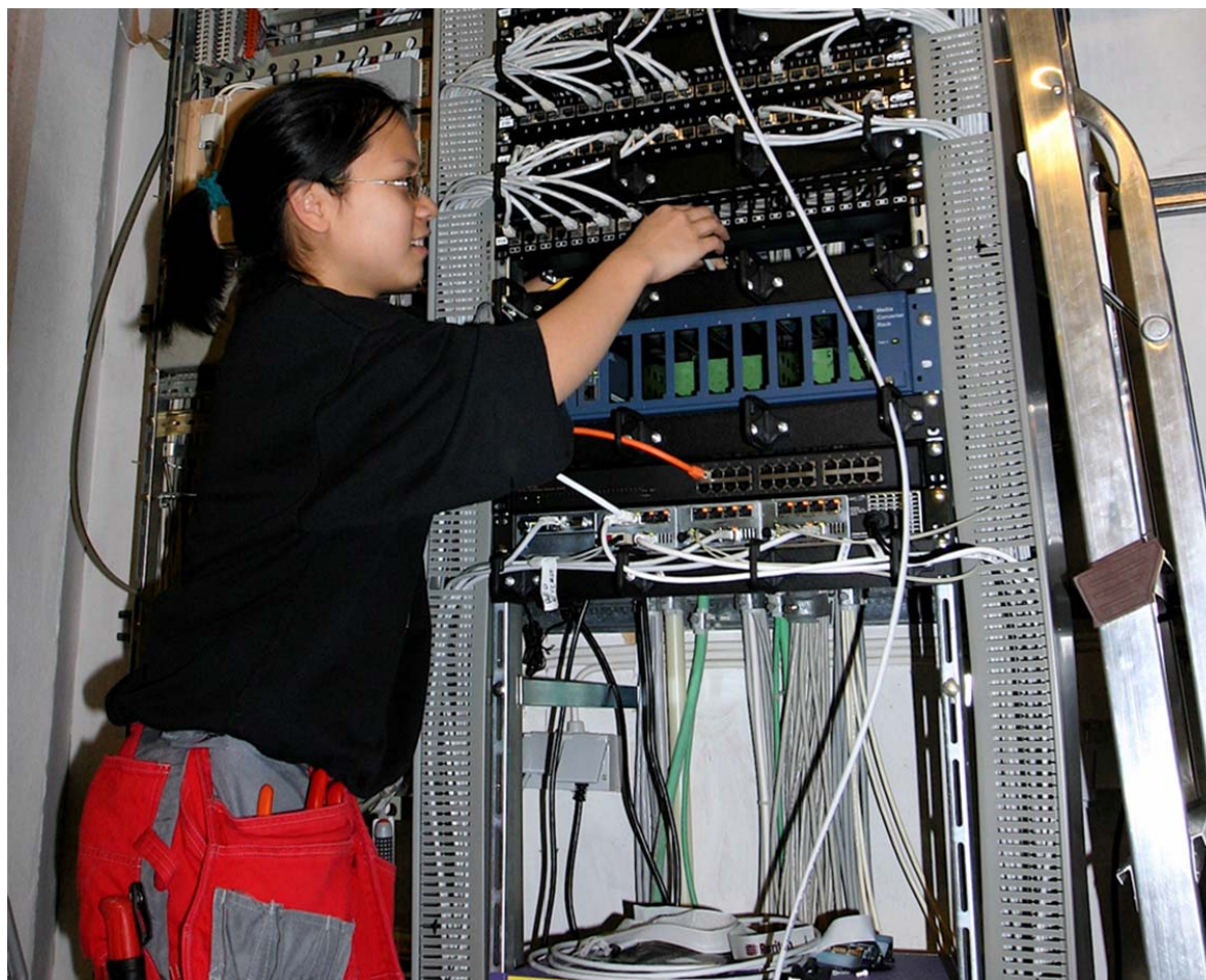
Foto: Elektriska installatörsorganisationen, EIO
