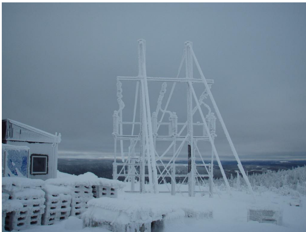
Friledningens sista stolpe innan övergång till markkabel uppe på Uljabuouda
