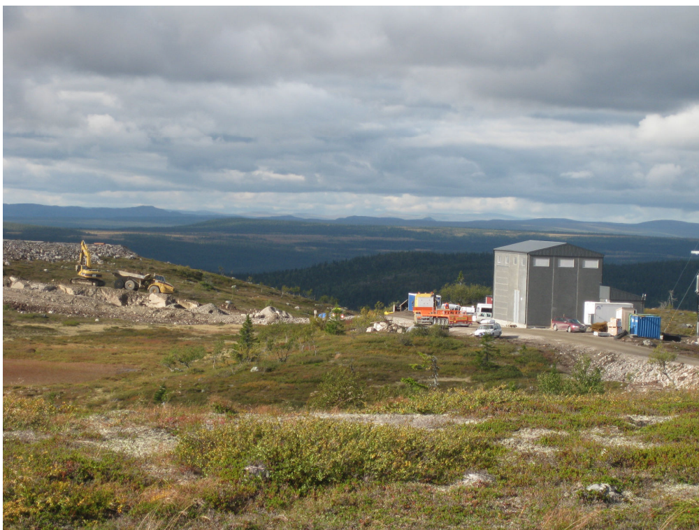
Den inbyggda transformatorstationen under byggtiden
