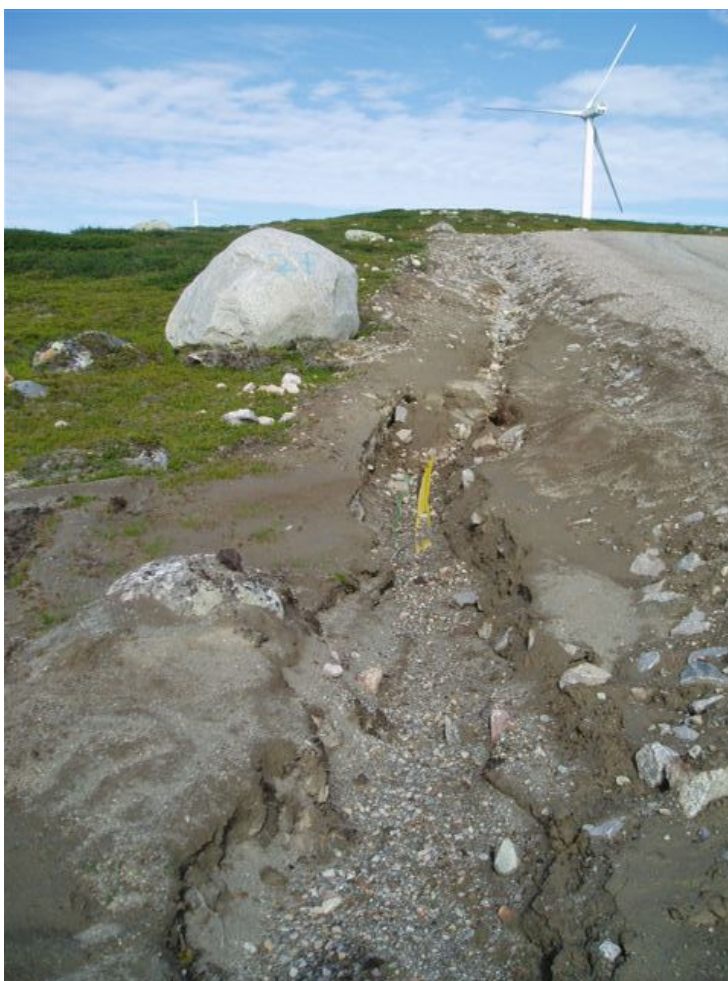
Erosionsproblem i kabelgrav
