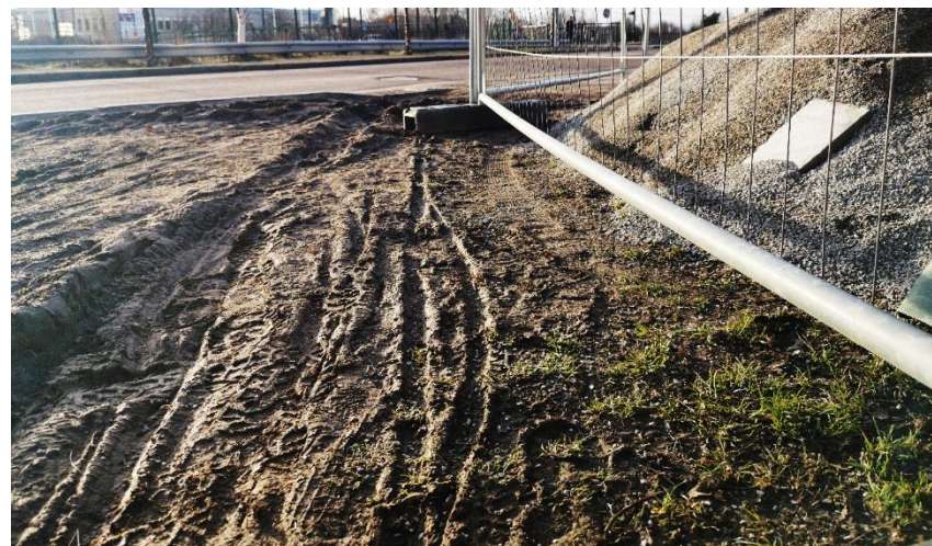
Foto, Jussi Björlings väg, 2020-02-18. Gåendes och cyklisters färdväg när cykelbanan blockeras av byggprojekt. Foto: Victoria Bengtsson
