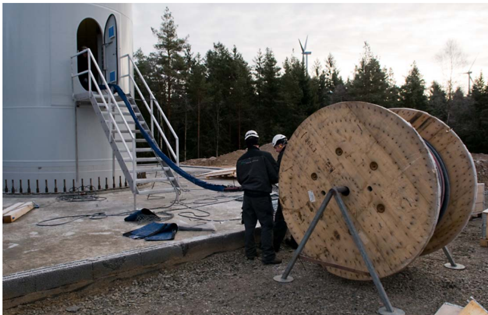
Bild 26: Anslutning av 36 kV kabel
