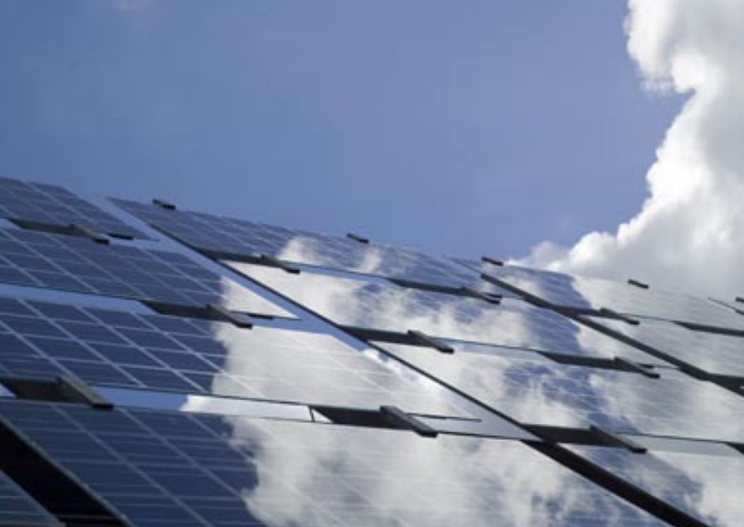
Solceller. Foto: Marco Pusterla
